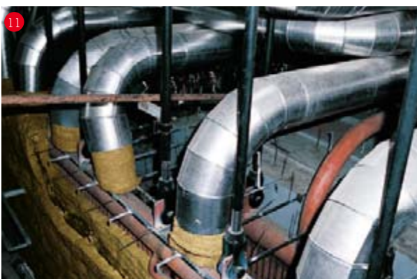
Plechové opláštění kolen ze segmentů a potrubí
