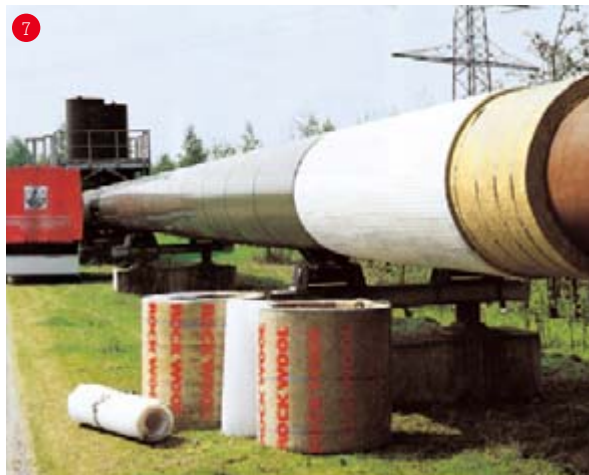
Potrubní pouzdra na potrubí omezují hluk
