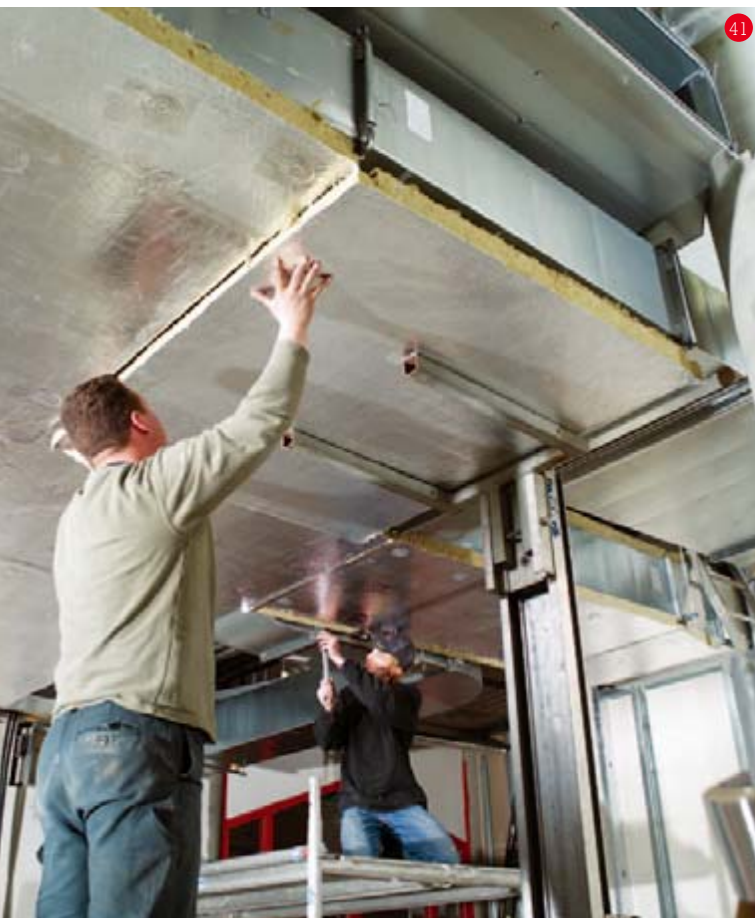
Požární izolace vzduchotechnického potrubí
