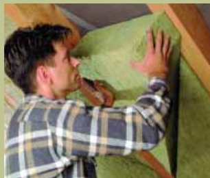
Hőszigetelés szarufák között és alatt
