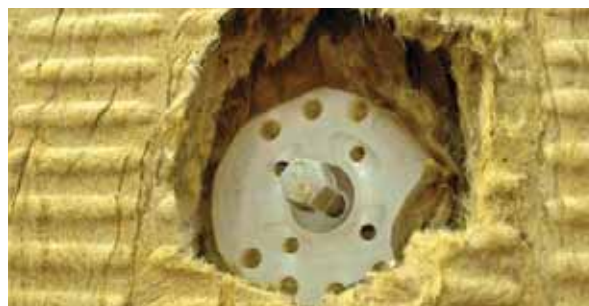
Ukázka špatně zapuštěné hmoždinky (obr. 31)
