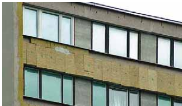
Chybné riešenie skladby dosiek (obr. 19)
