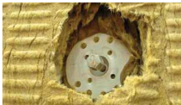
Ukážka nesprávne zapustenej kotvy (obr. 31)
