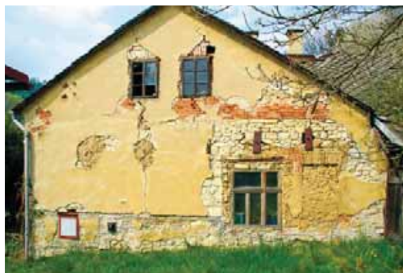
Nevhodný podklad pre zateplovanie – nutné odstrániť trhliny a príčinu ich vzniku (obr. 11)
